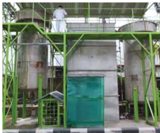
図3. 12m 3 の反応槽をもつ工場排水処理パイロットプラント (アジア新興国)
