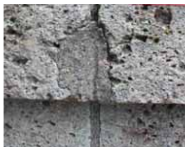
図6 大谷石の不適切な補修
