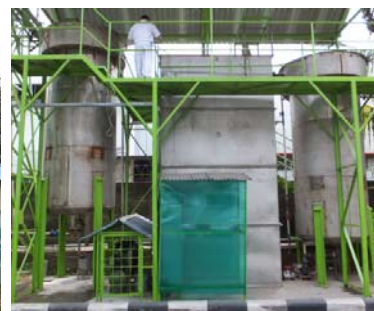
アジア新興国に設置された工場排水処理のための磁化活性汚泥パイロットプラント (曝気槽12 m³)
